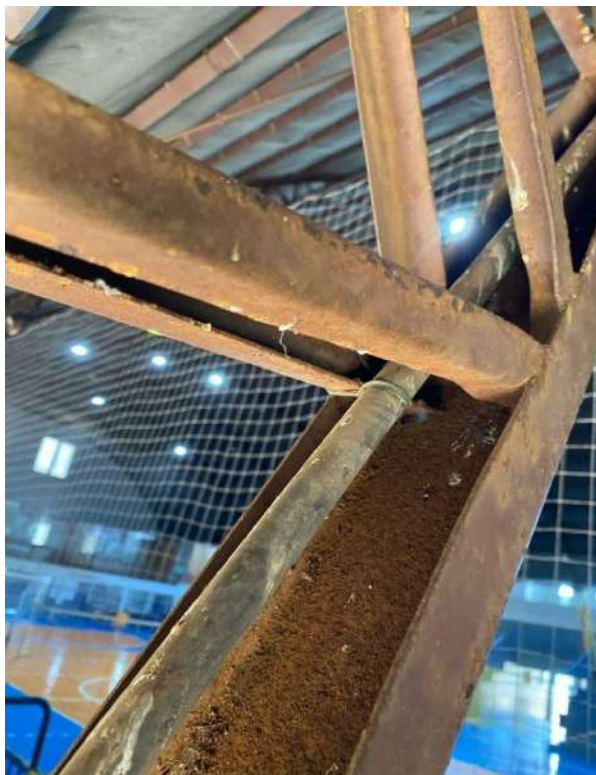
Imagem 21 - Corrosão presente em treliça
