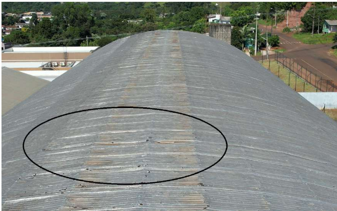
Imagem 26 - Danos em cobertura metálica
