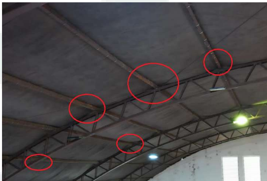
Imagem 22 - Corrosão presente em terças da cobertura
